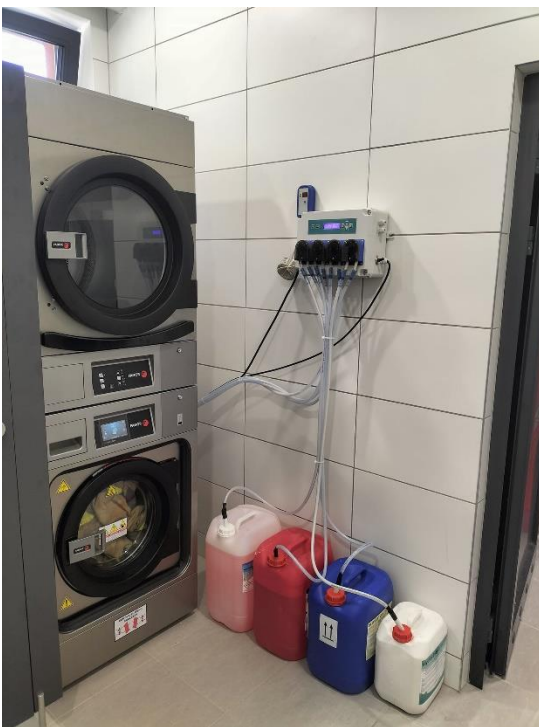
Fot. Pralnica – suszarka będąca na wyposażeniu OSP Morzeszczyn.
