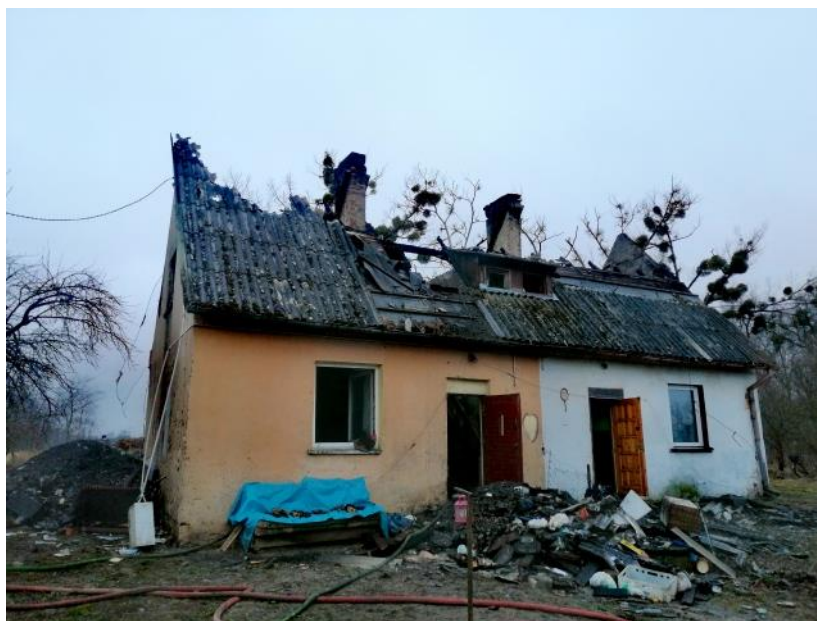
15.03.2021r. – Bielsk, Pożar Budynku fot. OSP Morzeszczyn
